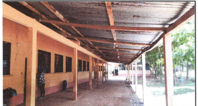
Foto 2: COSTANERAS SE ENCUENTRA EN MUY MAL ESTADO.
