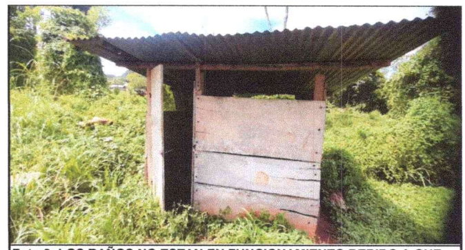
Foto 6: LOS BAÑOS NO ESTAN EN FUNCIONAMIENTO DEBIDO A QUE SE AVERIARON Y ESTAN EN MAL ESTADO.
